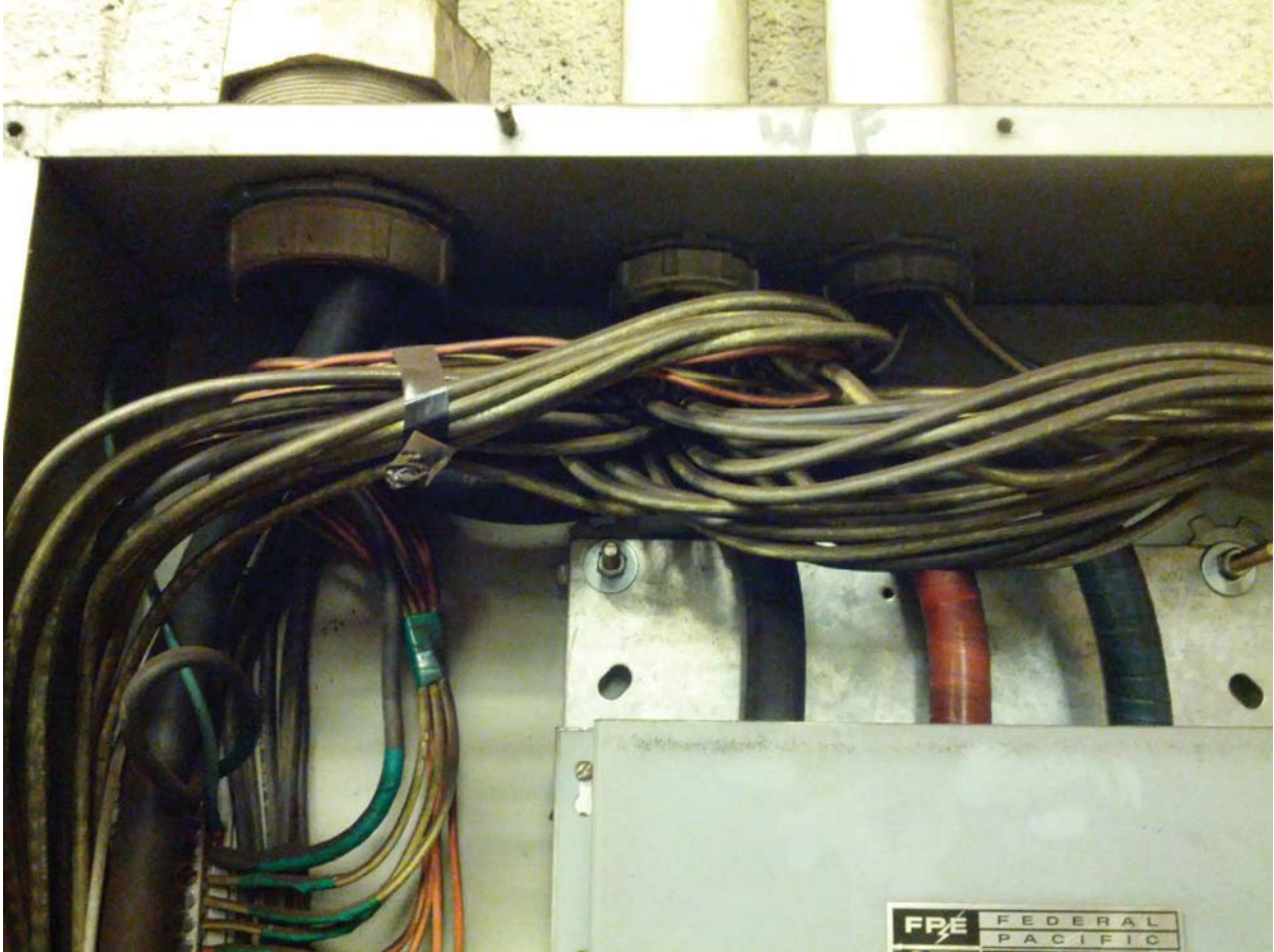
L'Enfant Plaza West Photo #3 – AFC Panel (WF) Top Feed Conduits
